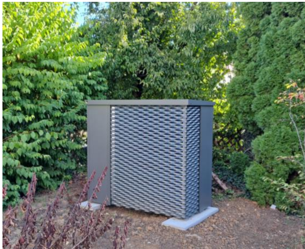
Außeneinheit einer Luft-Wasser-Wärmepumpe
